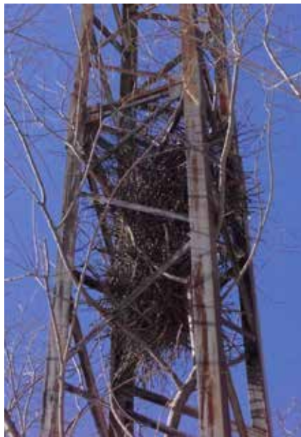
Рис. 2. Гнездо сороки внутри опоры ажурной ЛЭП
